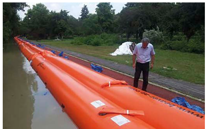
Bild 3 Geprüftes K4-System (Doppelschlauchsystem im Einsatz)
